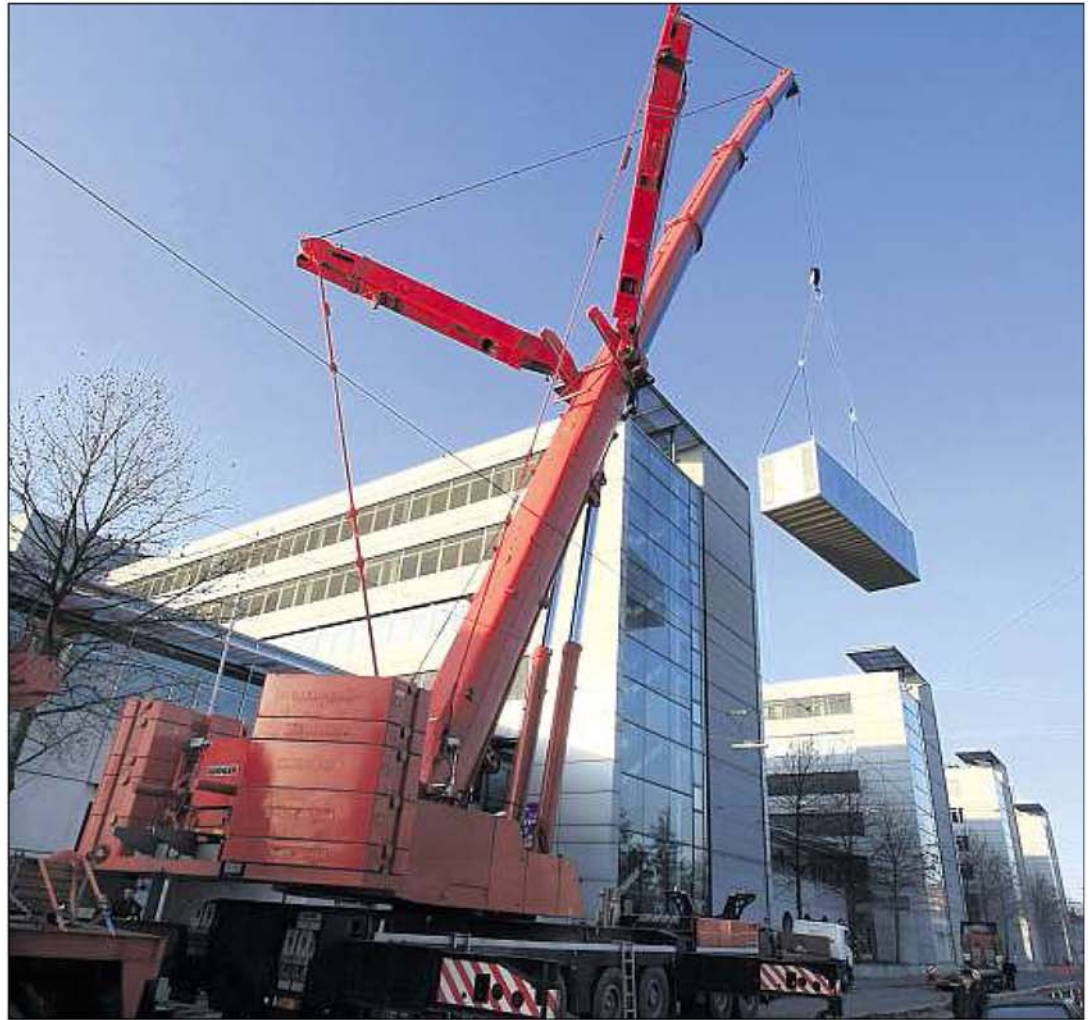
PRÄZISIONSARBEIT MIT SCHWEREM GERÄT: Mit den Notstromaggregaten auf dem Dach der EnBW-Zentrale soll der Betrieb auch bei Stromausfällen reibungslos vonstatten gehen. Foto: jodo
